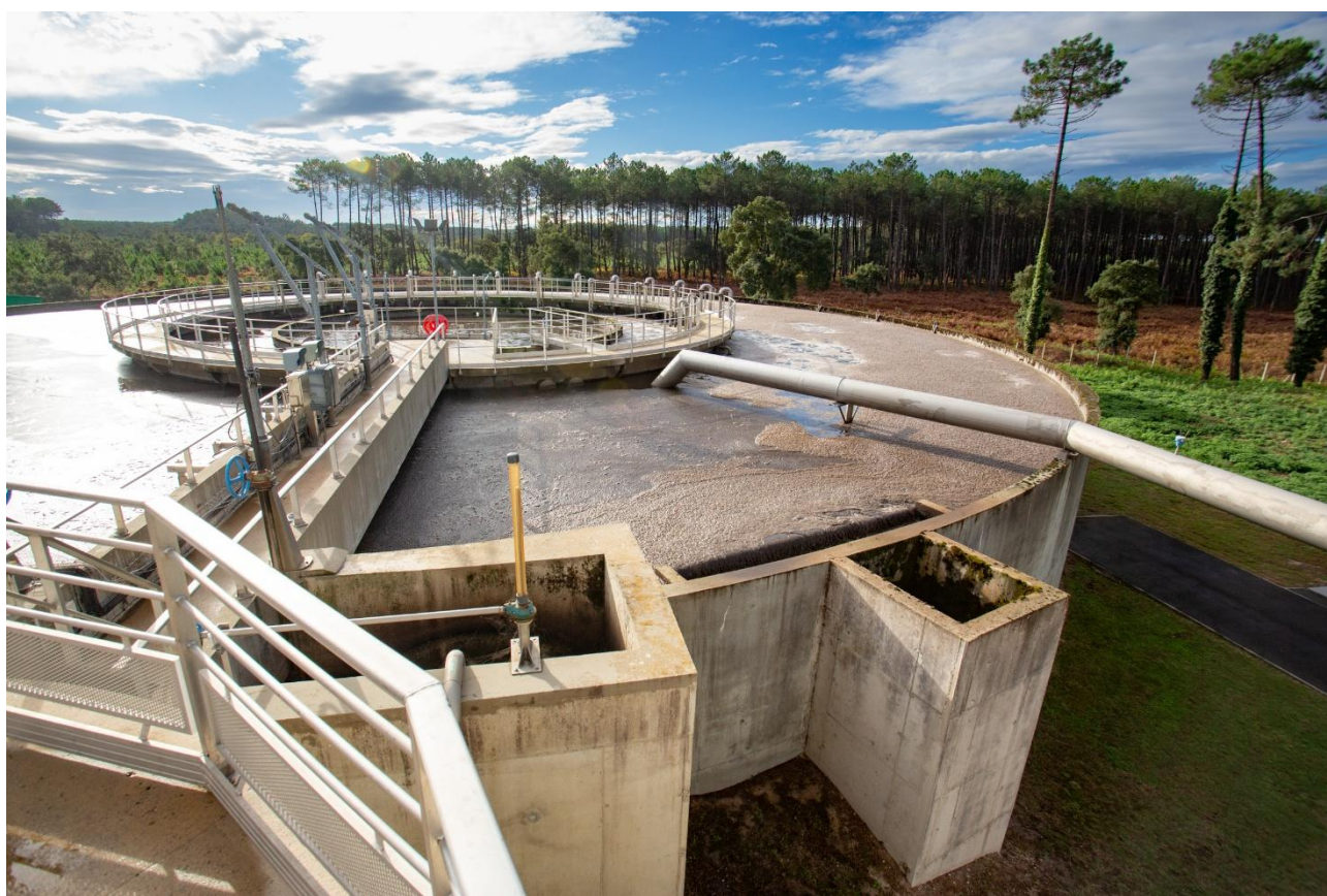
Station d'épuration de SOUSTONS : 100 000 EH
